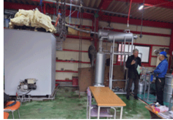
廃タイヤ再生油実験プラント
