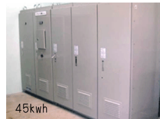
45kwh リチウムイオン蓄電池設置例
