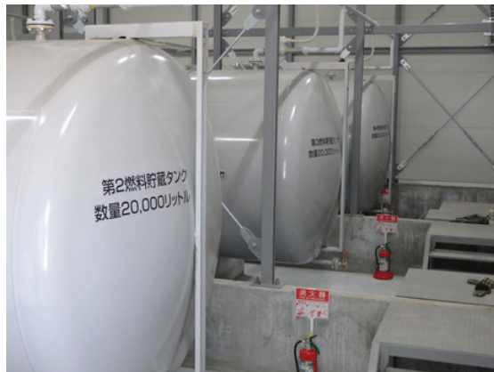
80t 貯蔵タンク
