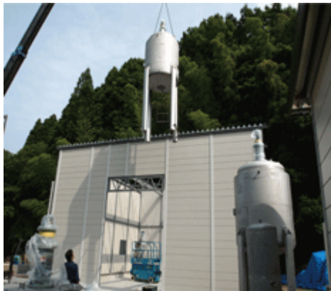
設計施工・BDFプラント
