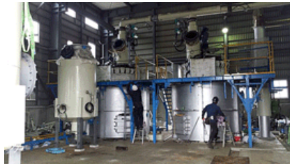
廃タイヤ再生油プラント
