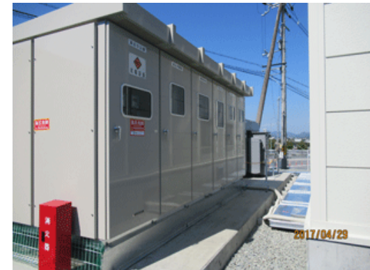
昇圧制御キュービクル
