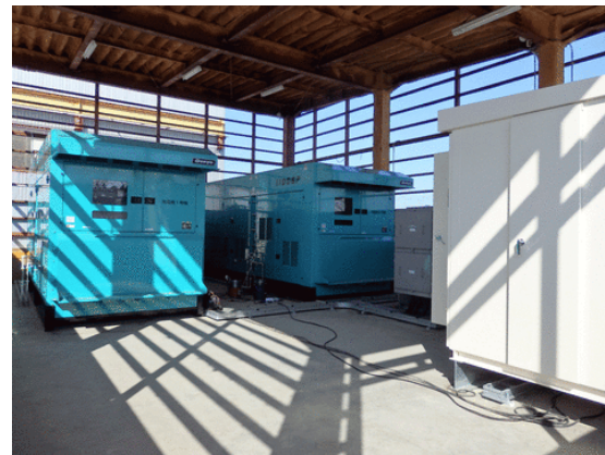
2000kw-発電設備
