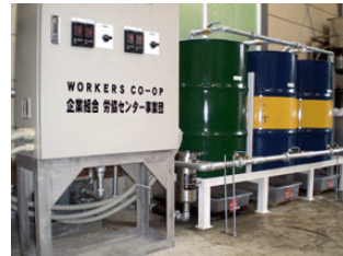
BDF装置-制御盤類
