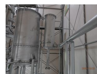
廃タイヤ油化装置 一部
